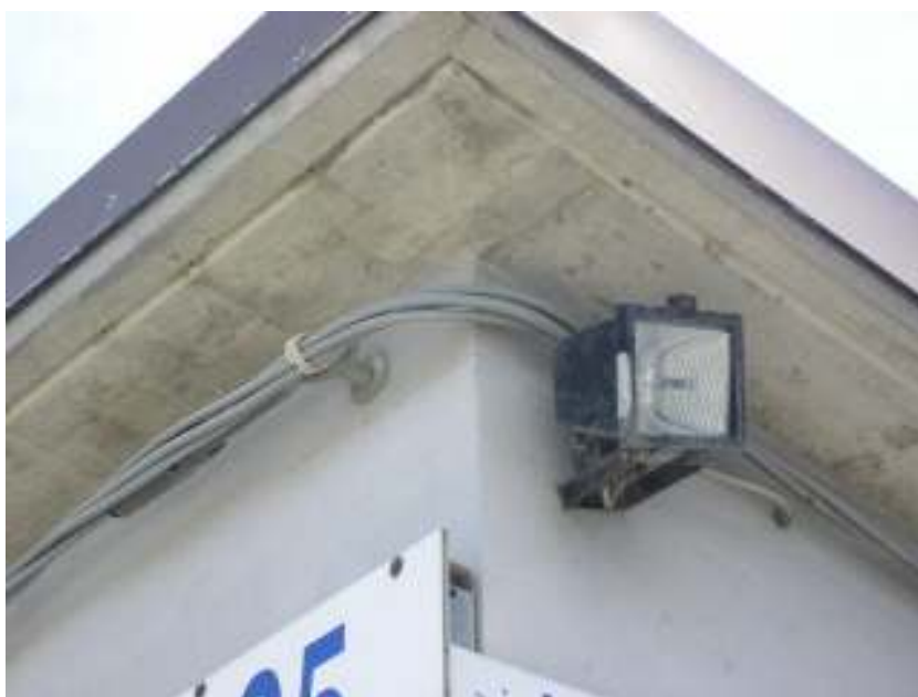
Figura 10.3.1-3 Impianti di illuminazione esterna nell'area portuale (Tipologia 3)
