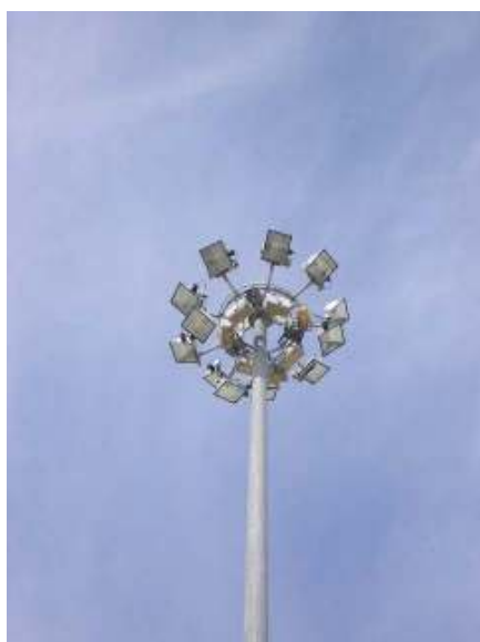
Figura 10.3.1-1 Impianti di illuminazione esterna nell'area portuale (Tipologia 1) di giorno e di notte
