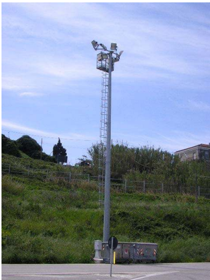
Figura 10.3.1-2 Impianti di illuminazione esterna nell'area portuale (Tipologia 2)
